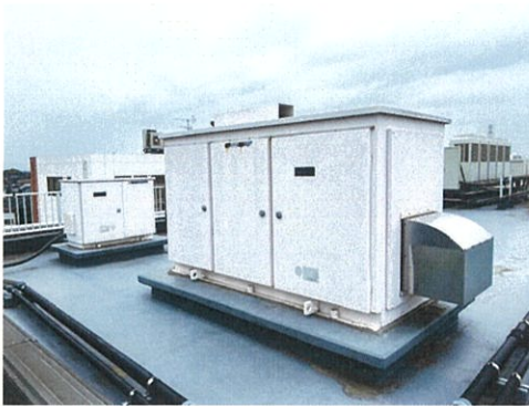
自家発電装置
